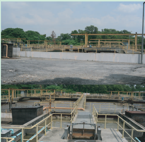
Loji rawatan kumbahan yang terletak di kawasan Hulu Langat
