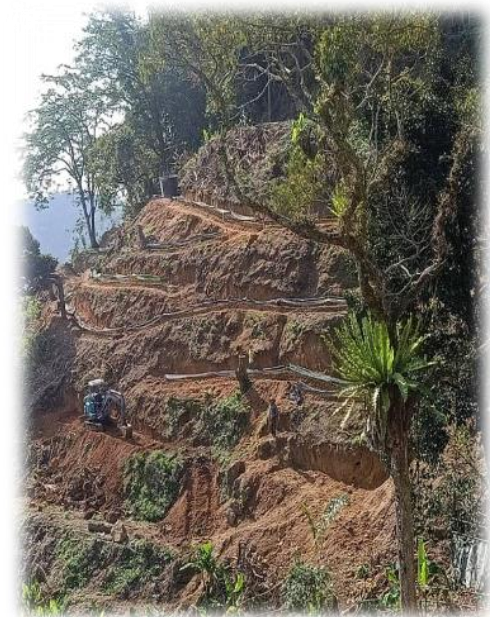
Kerja-kerja penggalian tanah yang berbahaya/ berisiko di kawasan curam adalah tidak digalakkan
